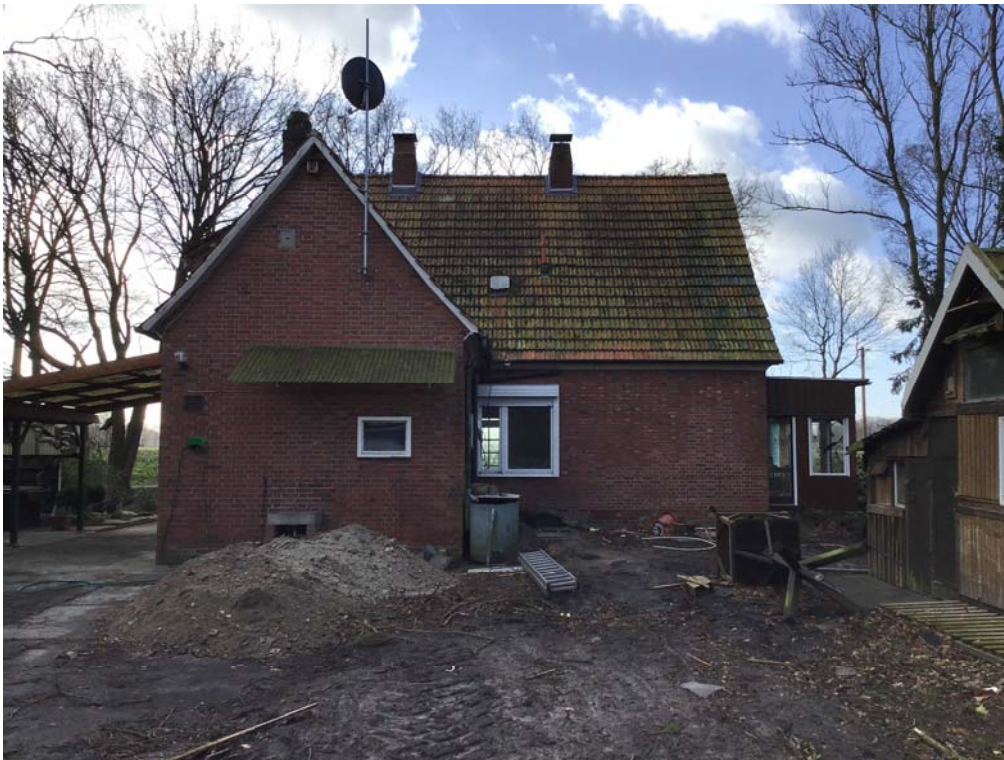
Foto 31: Blick auf die in Richtung Nordosten ausgerichtete Hausfront des im Umbau befindlichen Wohnhauses W35
